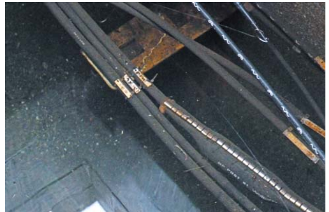
Im Extremfall kann es durchaus vorkommen, dass ein Kabelschacht komplett unter Wasser steht.
